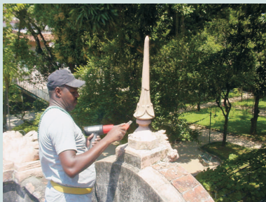
29.02.08 Preparação da superfície da fachada para pintura – remoção com espátula de antigas demãos de pintura - pináculo
