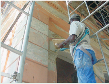
16.04.08 repasse de argamassa de cal nas áreas de onde foi retirada argamassa irregular
