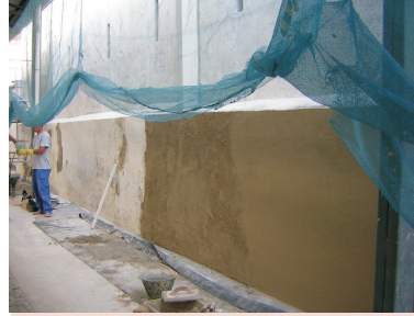
29.05.08 repasse de argamassa nas áreas onde houve remoção de argamassa irregular (fachada fundos)
